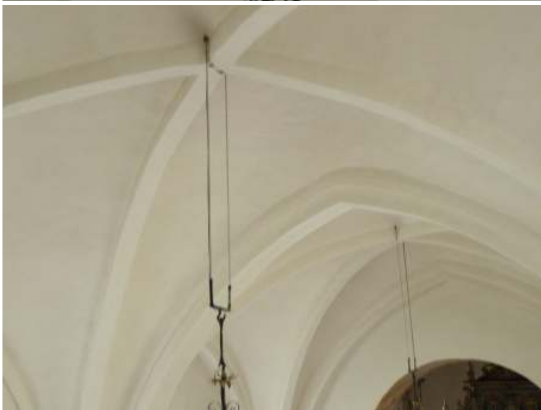
Överst: Ljuskronornas upphängningsanordning består av en smidd bygel. Bygelns två ingångshål utnyttjades för kabeldragning till belysningslifterna. En spotlight är sedan tidigare installerad i anslutning till ljuskronan i öster. Bilden tagen före åtgärder. Underst: Efter installation: ljuskronorna i nedbissat läge. Bilden tagen från sydväst.
