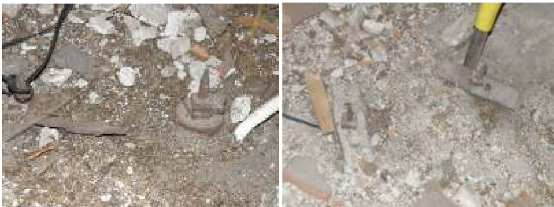
Ljuskronornas infästning på långhusvinden, Tv: den västra ljuskronan, th: infästning till ljuskrona i öster. Foton tagna före installation av belysningsliftar. I samband med installationen av liftarna avlägsnades muttrar och brickor.
