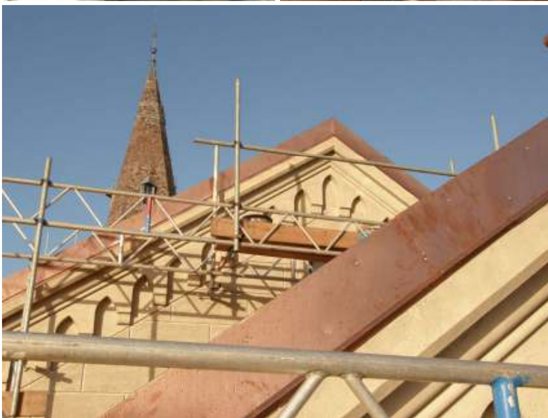
Översta raden: Tornanslutning på norra takfallet före och efter åtgärder. Nya ståndskeivor utfördes i koppar. Mittersta raden: Hängrännor på långbustaket före och efter åtgärder och materialbyte. Underst: Nya hängskeivor i koppar.
