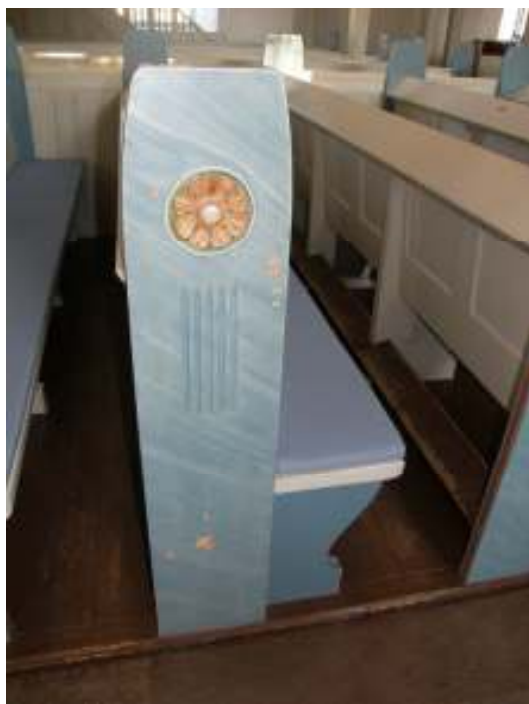
Bild till vänster: Skador i bänkinredningens målning.
