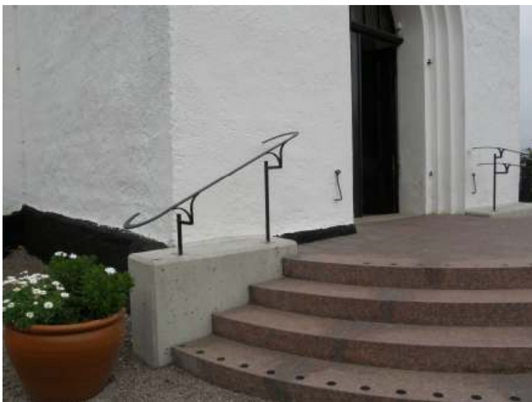
Räckets fäste vid trappans norra sida fick en onödigt klumpig utformning.
